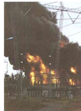
Kangasala 1984. Tre stycken 400/110 kV transformatorer brann upp.
