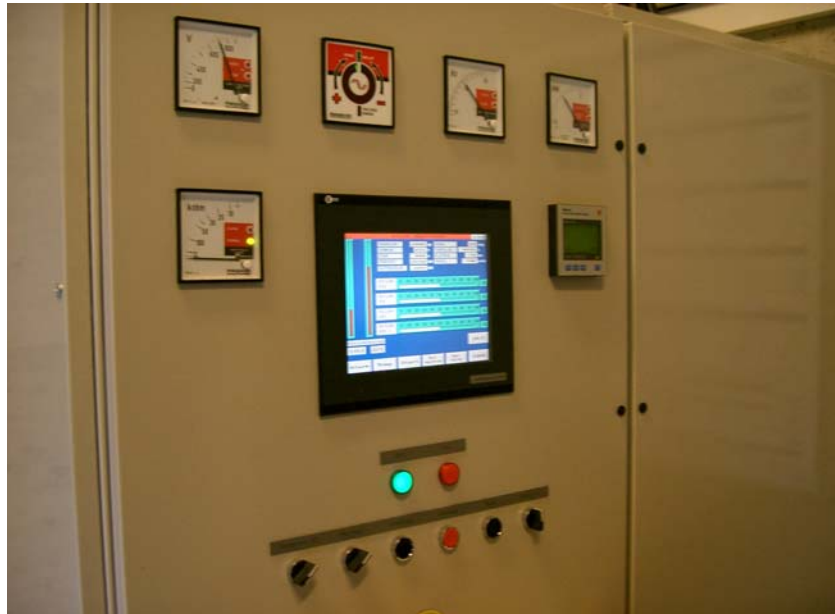
Figur 9: Övervakningsskärm för kraftverket
