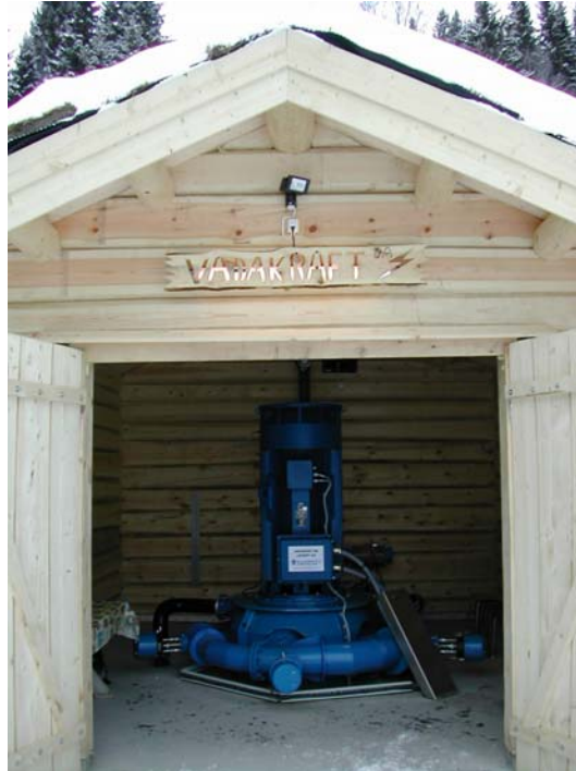
Figur 13: Turbinhus med en peltonturbin
