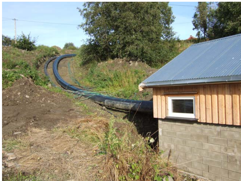
Figur 10: Vattenrör och turbinhus
