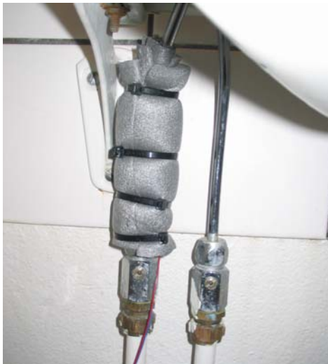
Figur 4.4: Installerad temperaturmätning på handfat.
