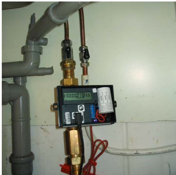
Figur 4.1: Mätning av tappvarmvattenflöde och temperatur under diskbänken i lunchrummet på 4:e våningen.
