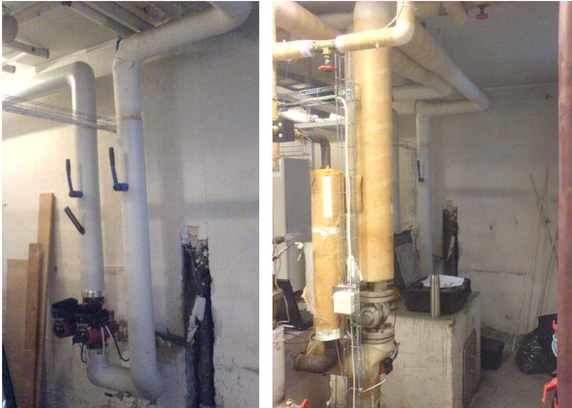
Figur 11 Till vänster: Cedergatans cirkulationspump sitter placerad i ett U-rör. Till höger: Pumpen syns i bakgrunden, nere till vänster i förgrunden syns radiatorväxlaren.
